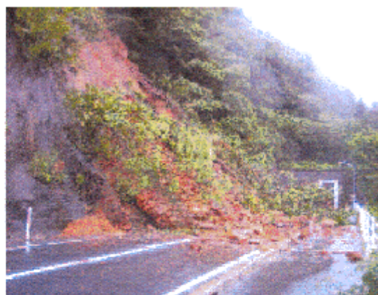
国道 314 号被災状況（島根県雲南市木次町）
