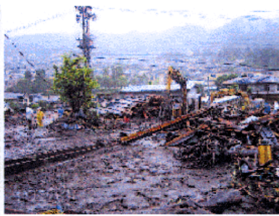
志平川土石流被害（長野県岡谷市橋原）
