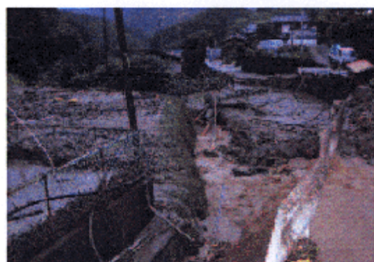
普通河川楠木川被災状況（熊本県山都町楠木）
