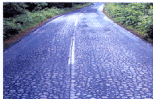
舗装面の凍上被害 町道野沢寺下線（青森県階上町）
