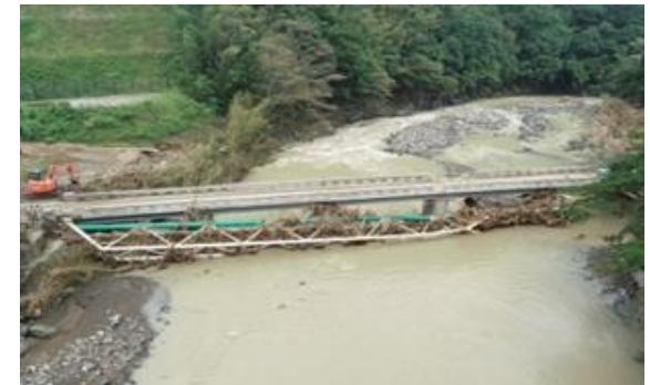
被災して崩落した水道管
