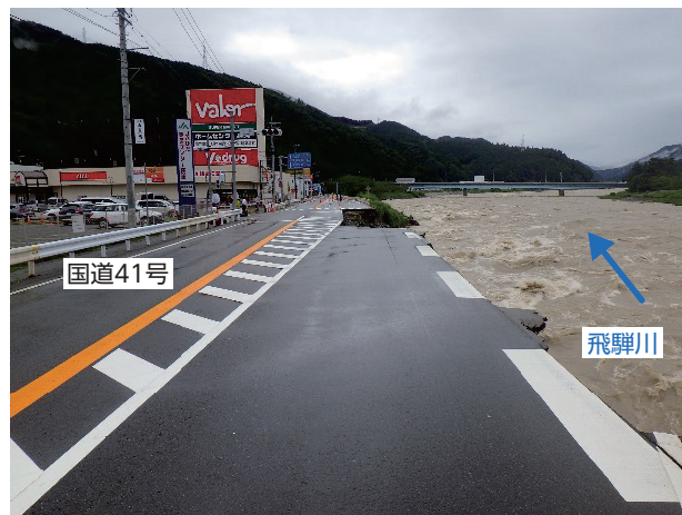
写真-3 令和3年8月豪雨による国道41号の崩落 (下呂市萩原町上村地内)
