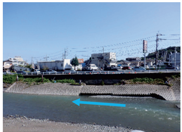
写真－3 金目川被災箇所
