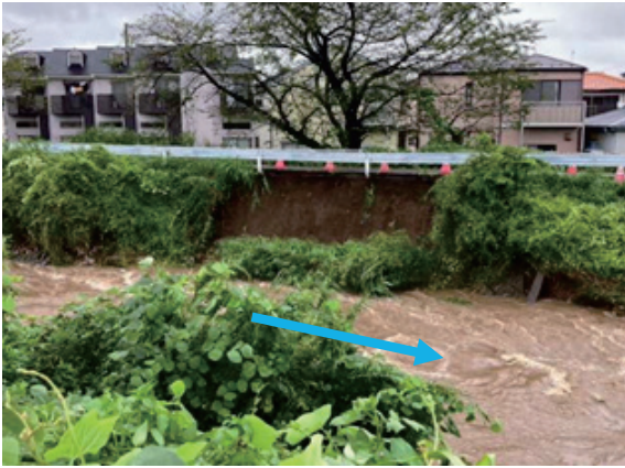
写真－4 荻野川被災箇所
