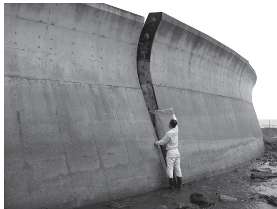
新潟県中越沖地震で被災した海岸堤防 宮川海岸 みやがわかいがん (新潟県 柏崎市 かしわざきし )
