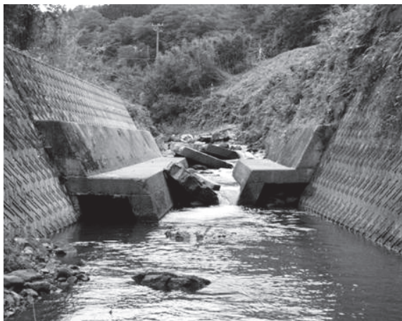
根継ぎ工で復旧した箇所が再度被災した事例
