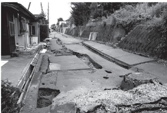
新潟県中越沖地震 液状化による被害を受けた山本団地 (新潟県 柏崎市) (写真提供：柏崎市) かしわざまし
