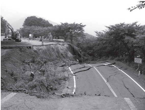
地すべり災害 国道136号（静岡県伊豆市）
