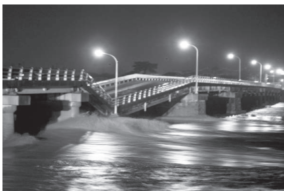
写真－4 被災状況
