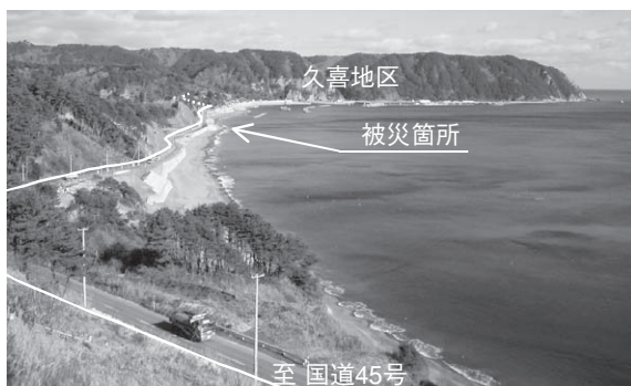
被災箇所遠景
