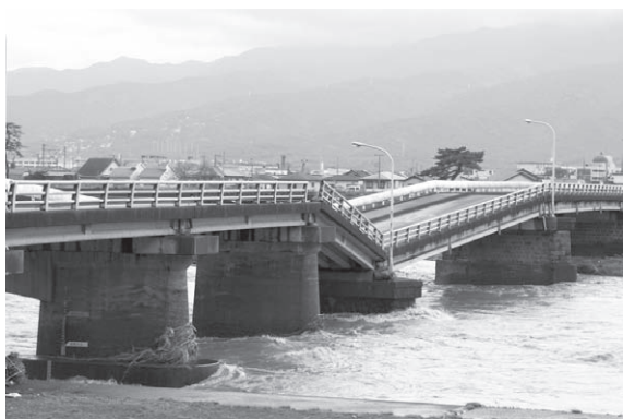
写真－5 被災状況
