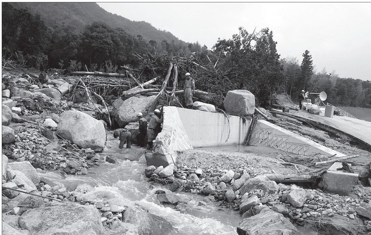
7 月 21 日からの豪雨による被災状況 (山口県防府市 真尾地区)
