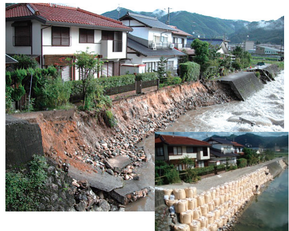
被災状況写真④
