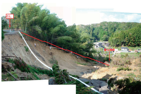
被災状況 (全景)
