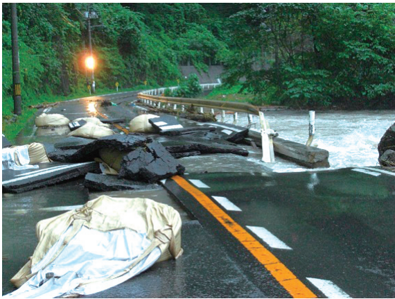
被災状況写真①
