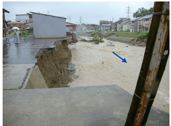
写真5-4 田川護岸欠壊状況（十日町市川原町地内）
