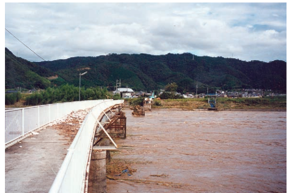
写真-1 平成10年台風10号による被災状況
