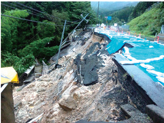
被災状況写真②
