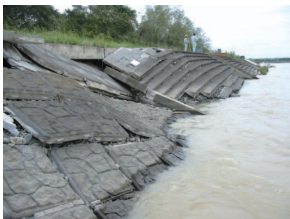
写真-3 相模川被災状況（平成23年9月）
