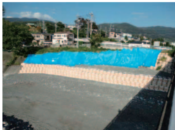
写真-4 酒匂川被災復旧状況（平成24年10月）
