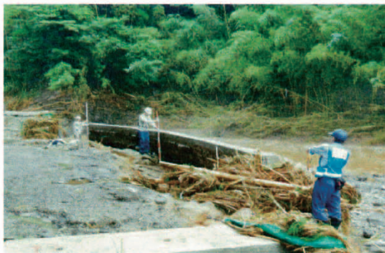
7月・九州豪雨道路復旧のための被災状況調査(大分県竹田市)
