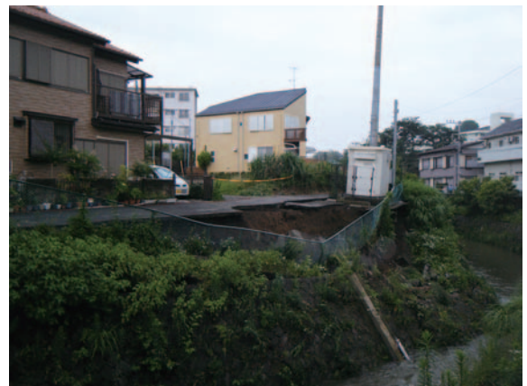
写真－1 平成23年6月11日 大岡川被災状況
