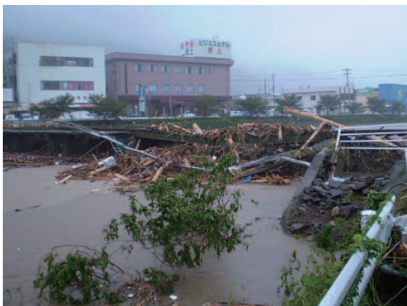
写真－ 6 JR 橋梁の流木による阻害
