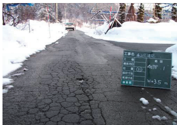
舗装面の亀甲状クラック及び盛上がり、沈下 (山形県東根市)
