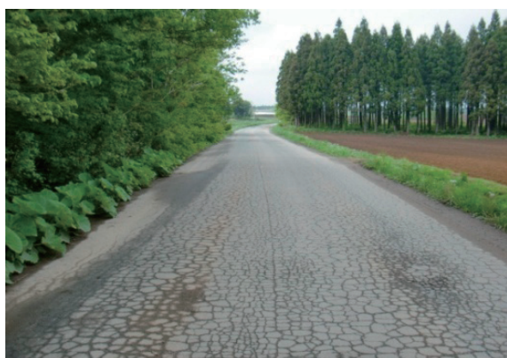
舗装面の亀甲状クラック及び盛上がり、沈下 (青森県東北町)
