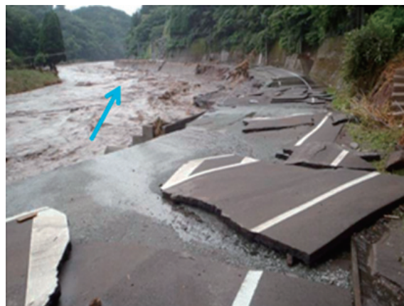
国道502号における路肩欠壊（大分県）
