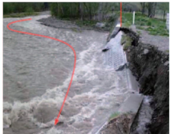
北海道 融雪災による護岸崩壊
