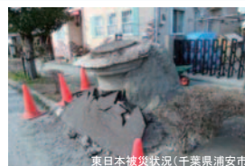
東日本被災状況（千葉県浦安市）
