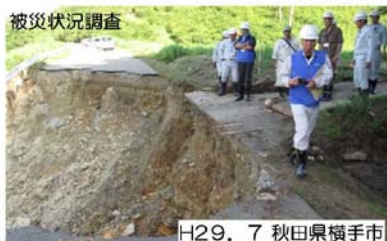
被災状況調査
