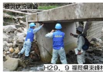
被災状況調査
