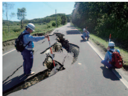
道路被災状況調査(安平町) (北陸地整)
