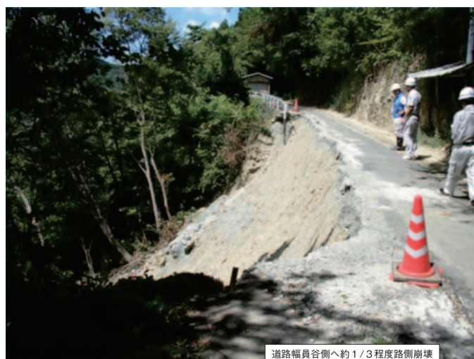
道路幅員谷側へ約 1/3 程度路側崩壊
