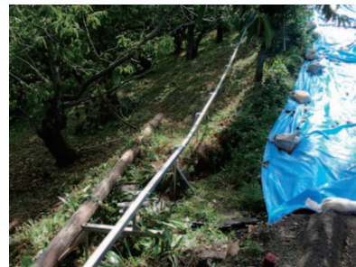
市道前面の法面～坂路 ：少しキレツあり
