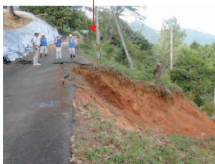
崩壊ブロック
