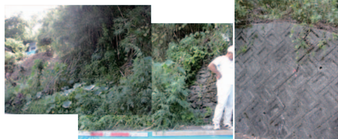
市道沿いの擁壁～(山に向かって) 左上部：民家畑にクラックあり ※大規模な路側崩壊（～全面道路 崩壊）：対策（共通項目関連）
