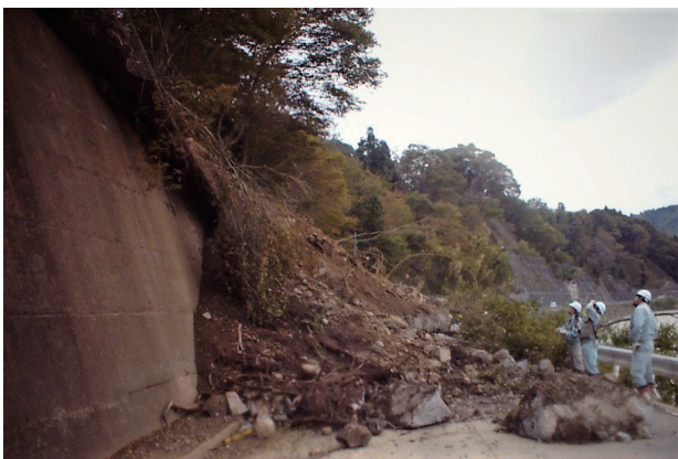
写真－7 木村地籍の土砂崩落状況
