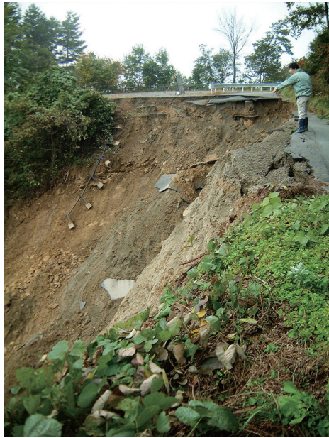
写真－6 高津屋地籍の大崩落状況
