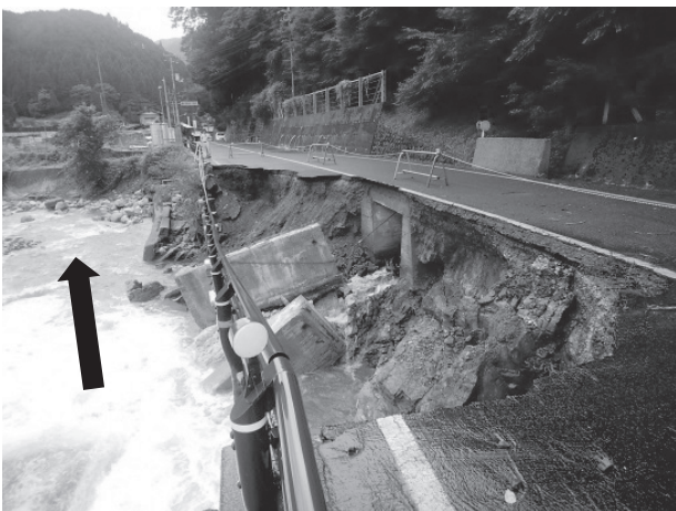
写真－1 兼用護岸の被災事例
