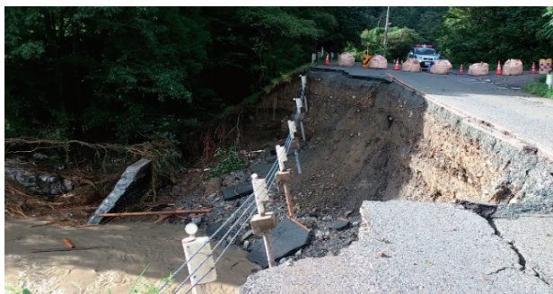
写真-3 H25年T18号被害状況（滋賀県高島市）
