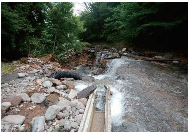
写真－4 令和2年災害 道路路肩崩壊状況
