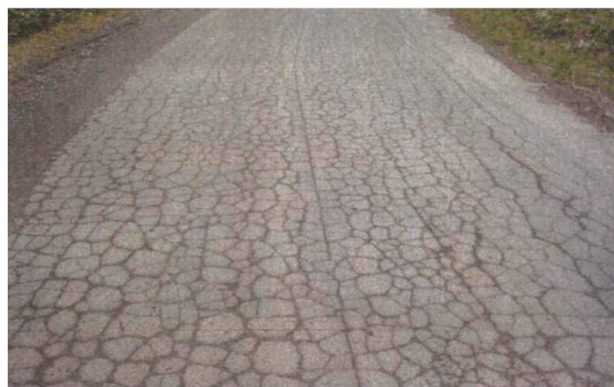
路面の亀甲状のひび割れ
