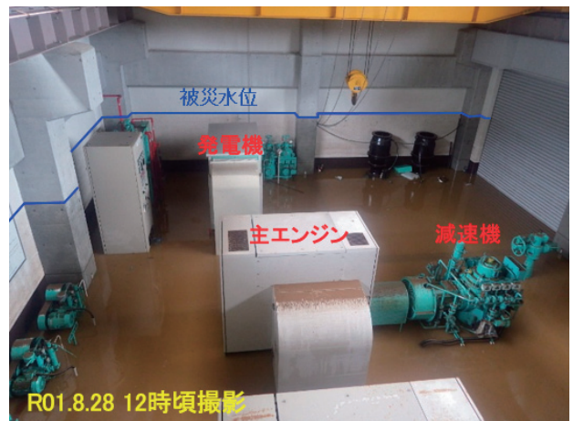
写真－6 排水機場建屋内浸水状況
