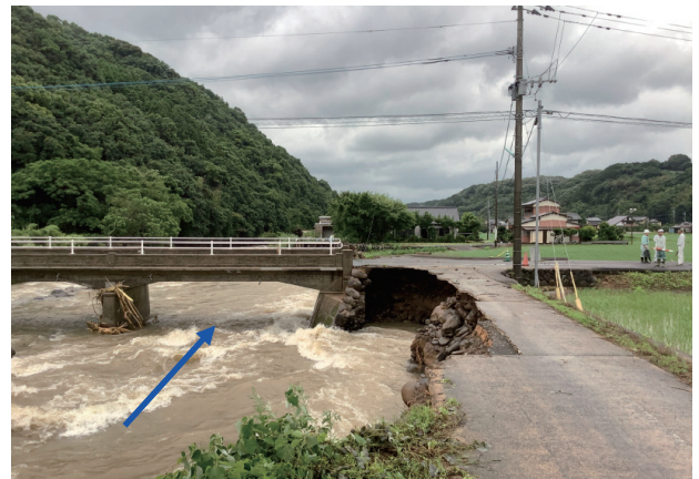
写真－5 令和2年災害 河川護岸流出状況
