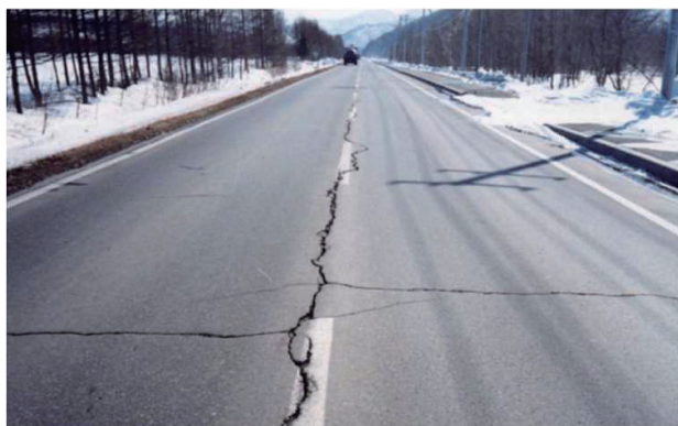
車道中央線に大きなひび割れ
