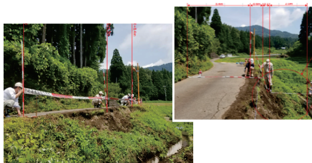
写真－１ 市道の路肩及び盛土法面崩壊（令和 2 年災）
