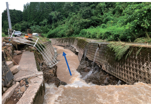
写真－2 令和元年災害 河床洗掘状況
