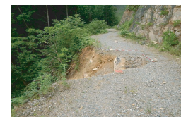
【林道施設の法面崩れ等】
