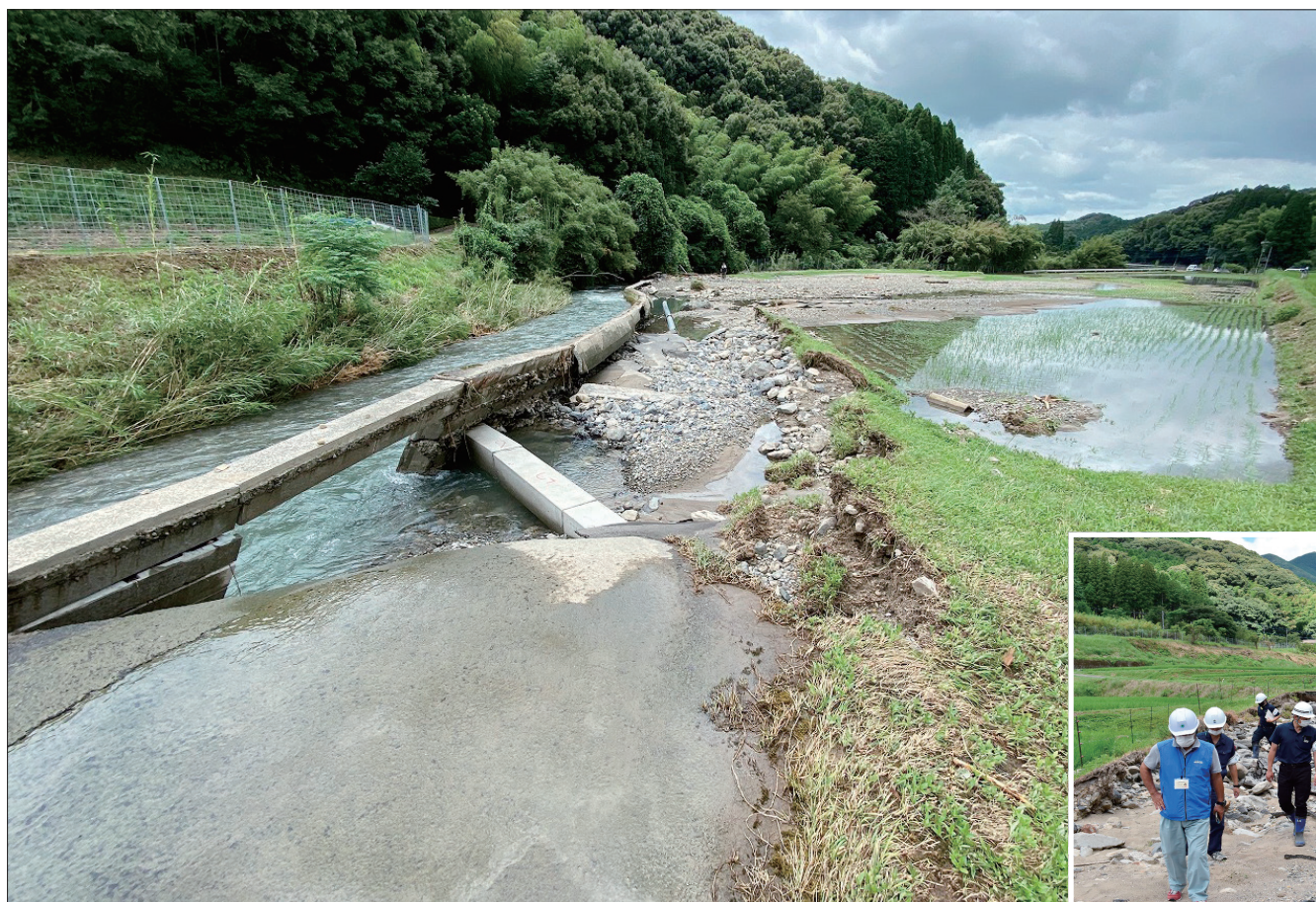
令和3年8月 災害復旧技術専門家派遣（鹿児島県さつま町）令和3年7月豪雨により被災した川内川水系海老川の護岸と町道
