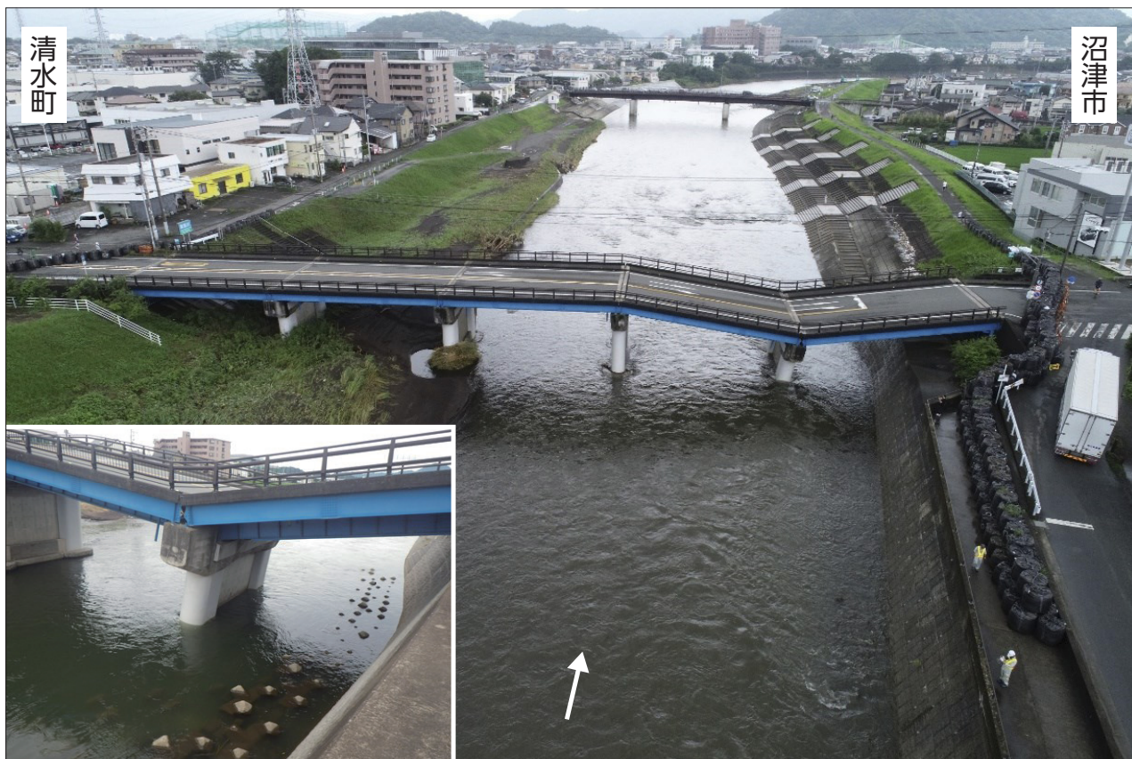
令和3年7月豪雨により静岡県沼津市と清水町を結ぶ黄瀬川大橋の橋脚1基が沈下
