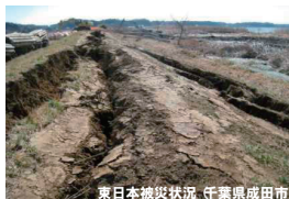
東日本被災状況 千葉県成田市
