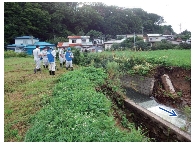
広戸川被災状況
