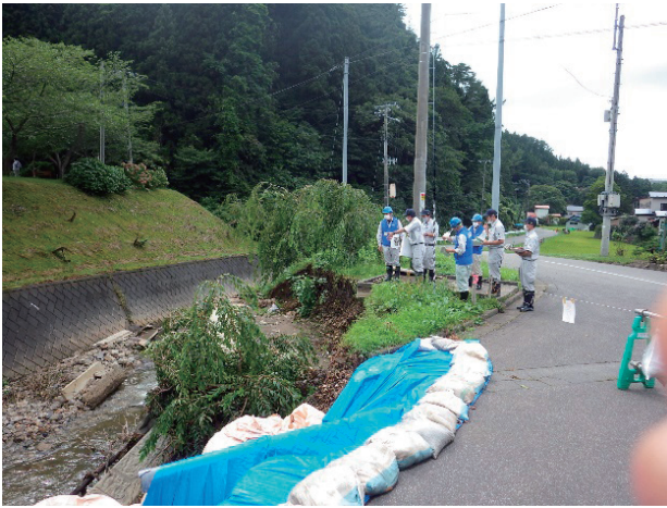
中沢川⑥ 被災及び現地説明状況
