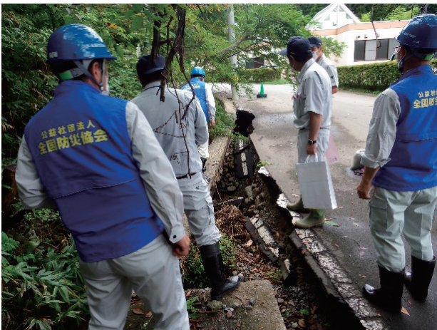
中沢川⑦ 被災及び現地説明状況
