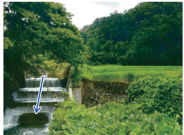
母沢川⑤-2 被害状況
