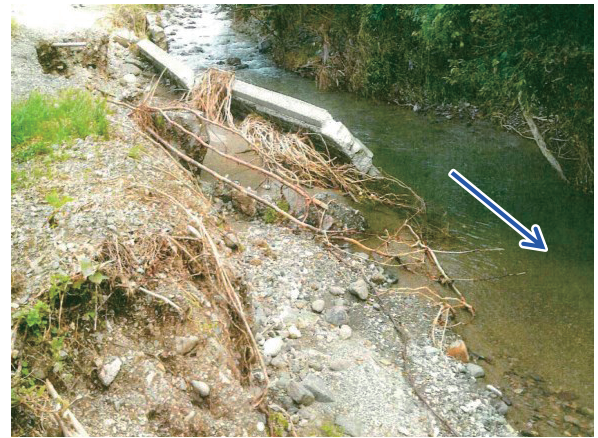
母沢川⑤-3 被災状況
