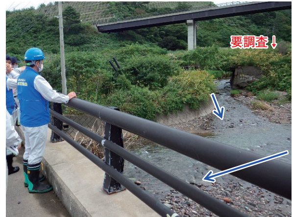
母沢川⑤-1 被災状況及び助言状況
