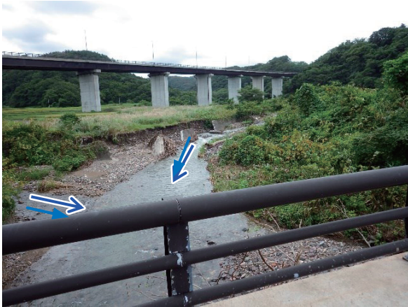
母沢川⑤-1 被災状況
