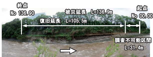
写真-3 河川護岸の被災
