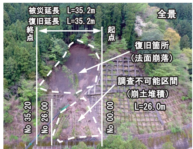
写真一 崩落土砂による道路法面埋塞
