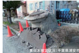
東日本被災状況(千葉県浦安市)
