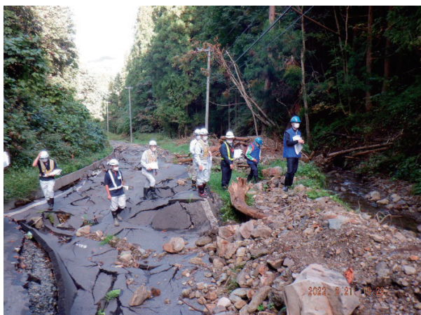
並行する河川から溢流箇所
