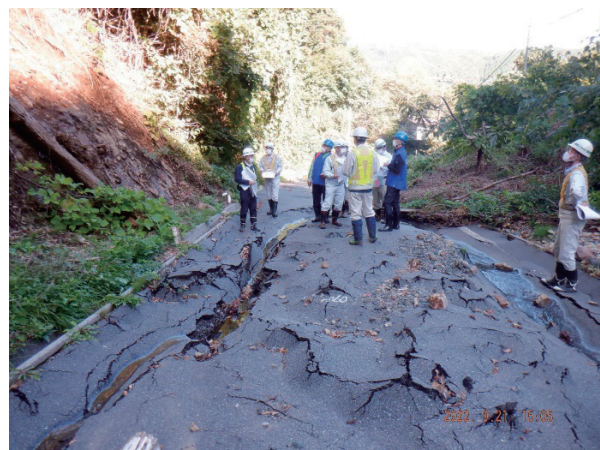
被災状況の確認
