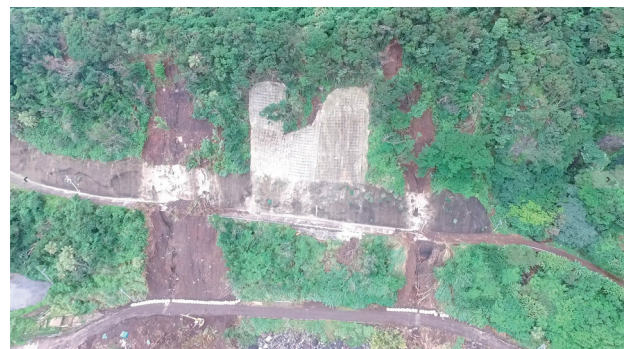
被災状況（着工前）
