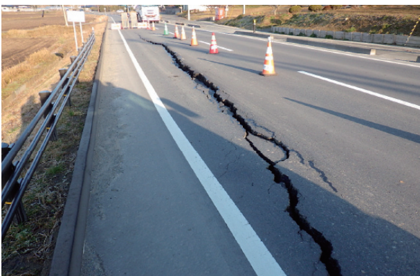
写真-4 地震による亀裂・沈下の発生状況
