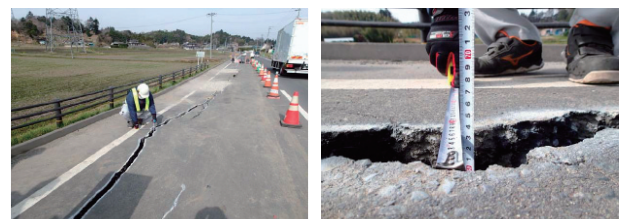
写真－1 スケールによる亀裂の計測
