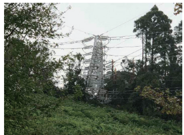
強風による鉄塔倒壊状況
