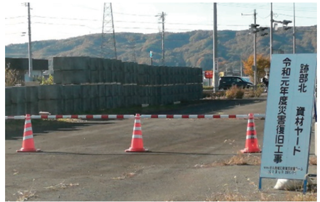
写真-3 資材ストックヤードの様子 (道路敷地のデッドスペースを活用)
