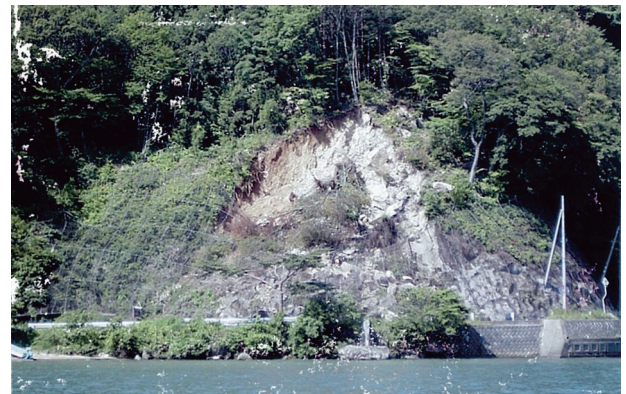
写真-1 地すべりによる被災事例
