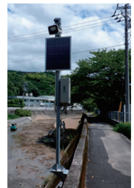
写真-2 簡易監視カメラ
