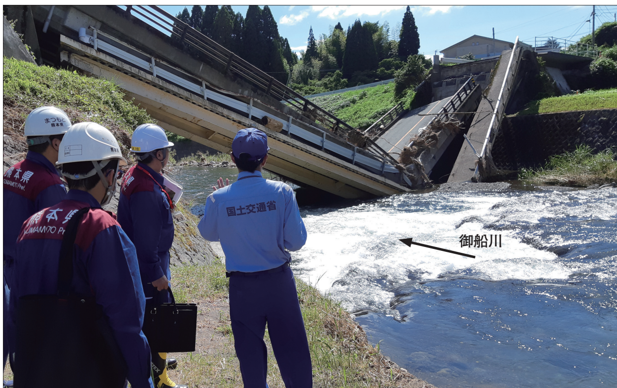
令和5年6月29日からの大雨関連の災害緊急調査 国道445号金内橋、熊本県山都町 やまとちょう (国交省 HP より)
