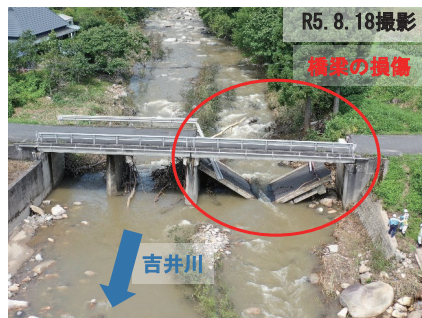
被災後の状況
