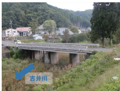
被災前の状況
