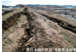
東日本被災状況(千葉県成田市)
