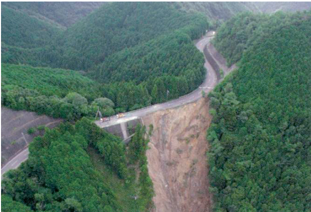
写真－1 23年災 県道田辺龍神線の被災状況 (延長約100mに渡って路側が崩落した)
