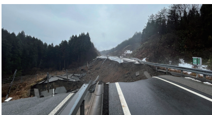
被災状況（盛土崩落箇所）
