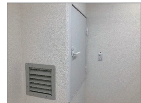
図 コンテナ内部の陰圧装置
