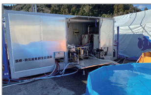
図 災害時におけるボイラーコンテナの状況
