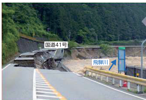
写真-2 令和2年7月豪雨による国道41号の崩落 (下呂市小坂町門坂地内)
