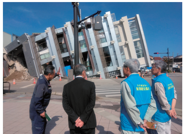
ビル倒壊現場（輪島市）
