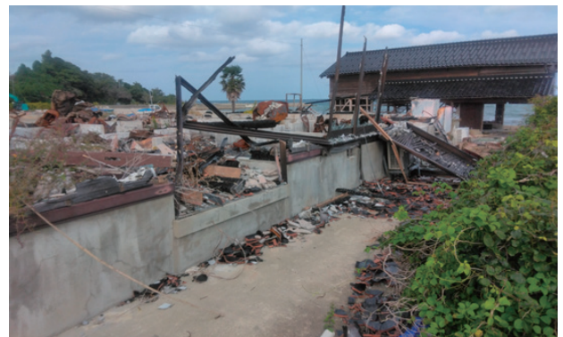
白丸地区の津波火災現場（能登町）
