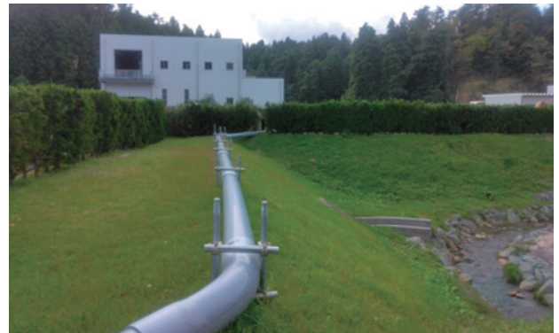
珠州市浄化センター（珠州市） 函渠が被災したため応急措置として地上に圧送管を設置
