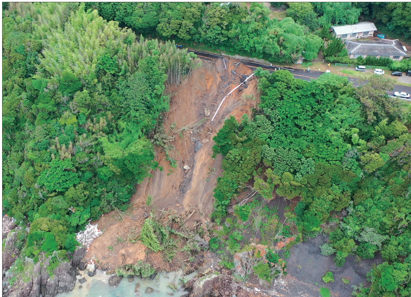
令和 6 年 7 月の大雨により主要地方道大社日御碕線の海側ブロック積擁壁が崩壊 写真提供：島根県
