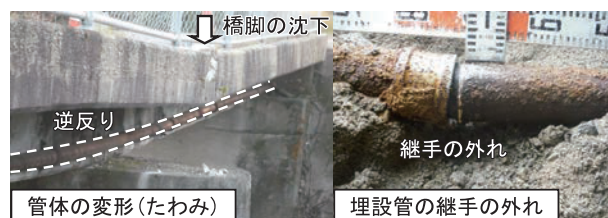
写真－5 橋梁添架管の被災
