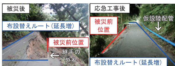
写真－4 配水管の被災（谷側のり面崩壊状況）と仮設陸配管
