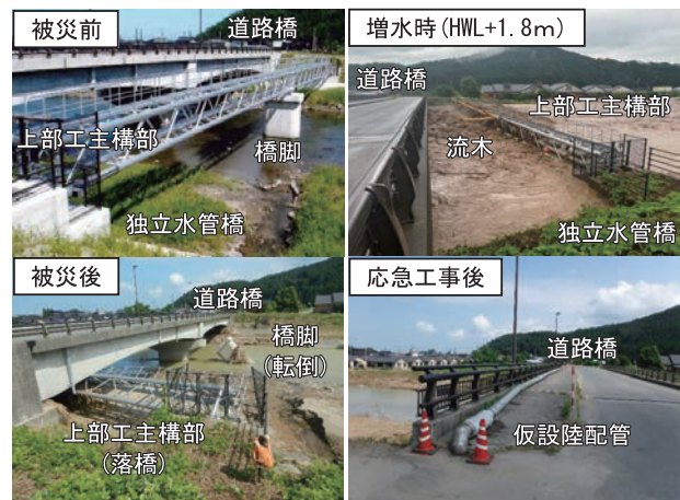
写真－3 独立水管橋の被災と仮設陸配管
