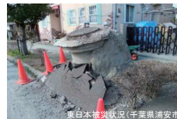
東日本被災状況(千葉県浦安市)
