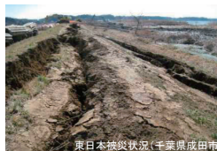
東日本被災状況(千葉県成田市)
