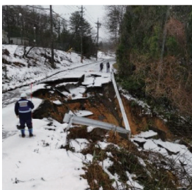
道路被害状況の調査
