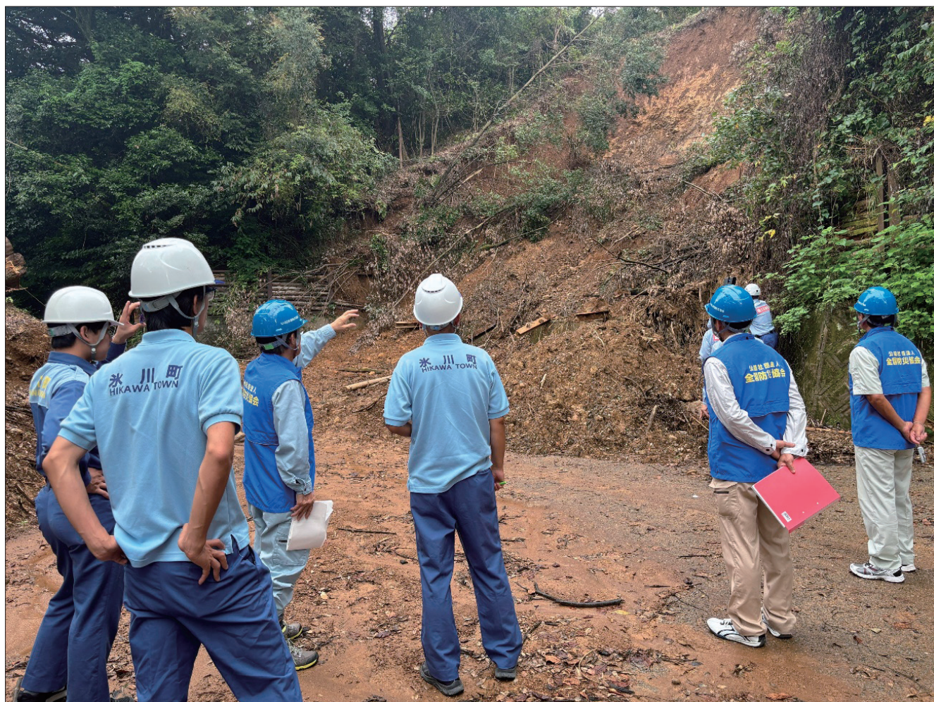
災害復旧技術専門家派遣（熊本県氷川町）令和 7 年 8 月 7 日から 12 日の豪雨により被災した道路・河川等の復旧支援（R7.9.17）
