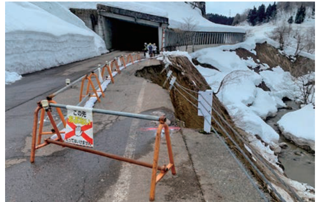
写真-2 谷側法面の被災
