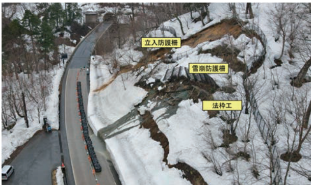
写真-1 山側法面の被災
