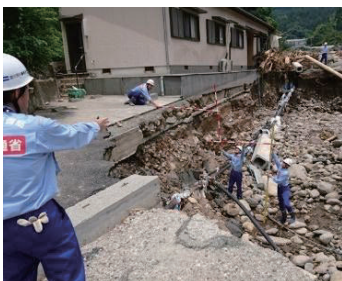
河川被害状況の調査
