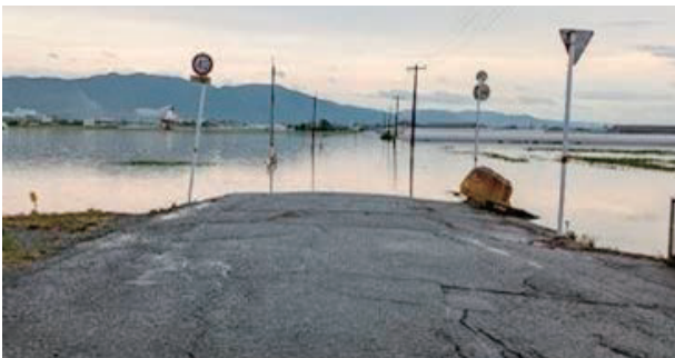
写真－1 豪雨による広域的な内水被害
