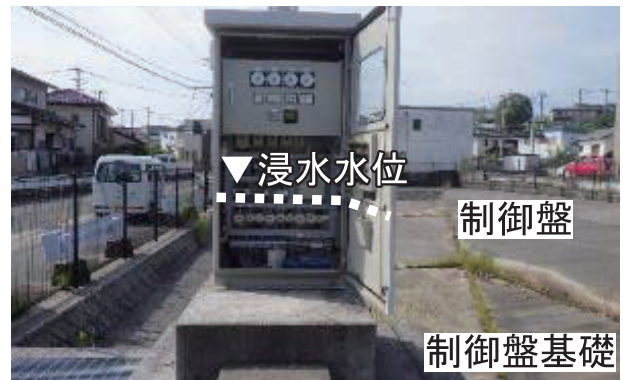
写真－2 制御盤の被災
