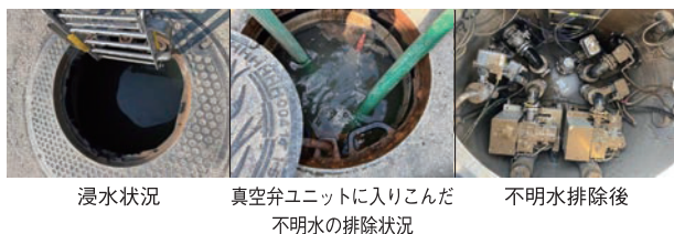
写真-5 真空ステーション（人孔）
