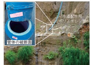
写真－8 被災状況
