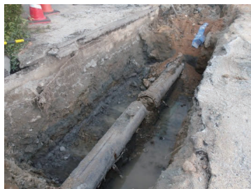
水道管の被害
