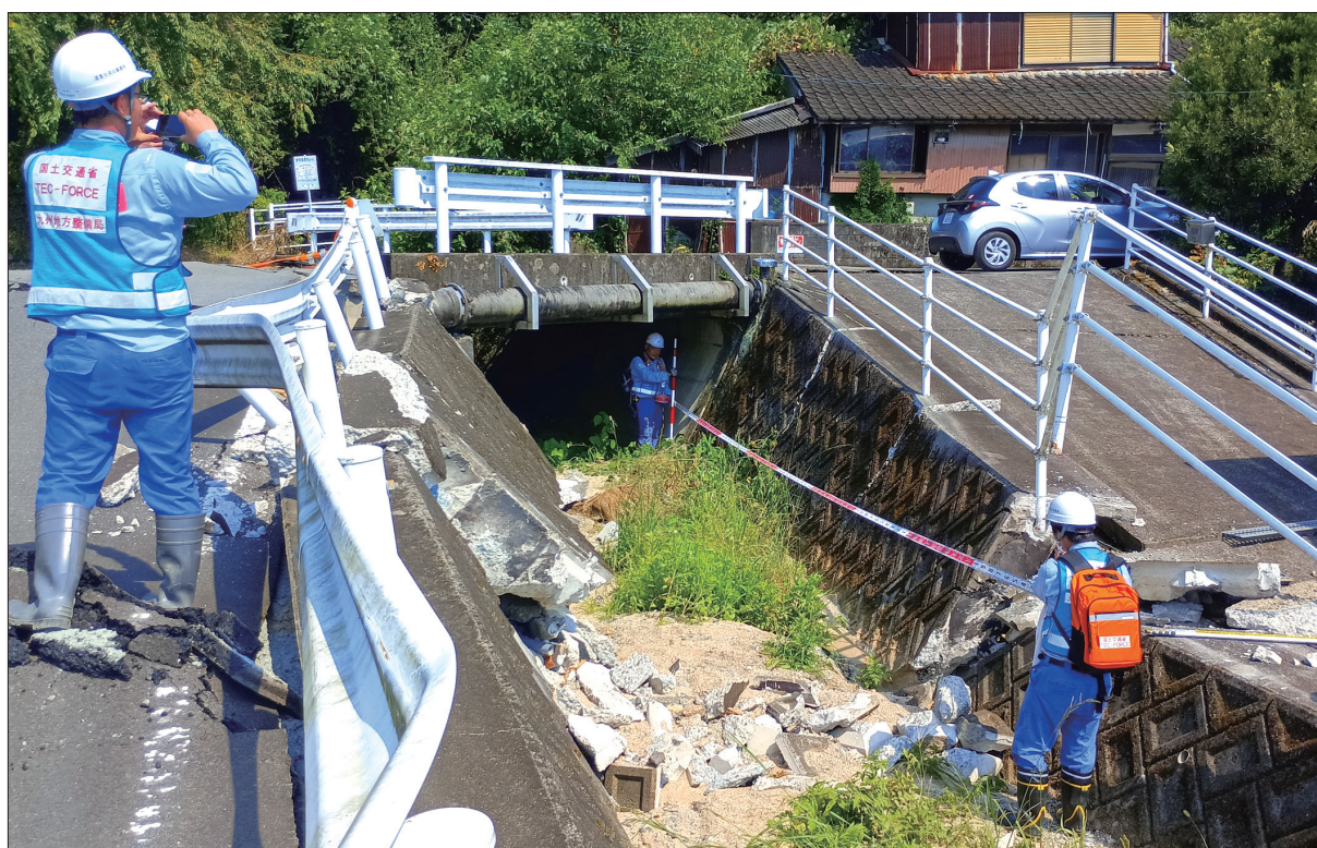
「令和 8 年熊本地震」熊本県氷川町 河川の被害状況調査 2026. 8. 2 (国土交通省 TEC-FORCE (テックフォース) 撮影)
