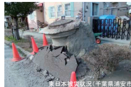
東日本被災状況(千葉県浦安市)
