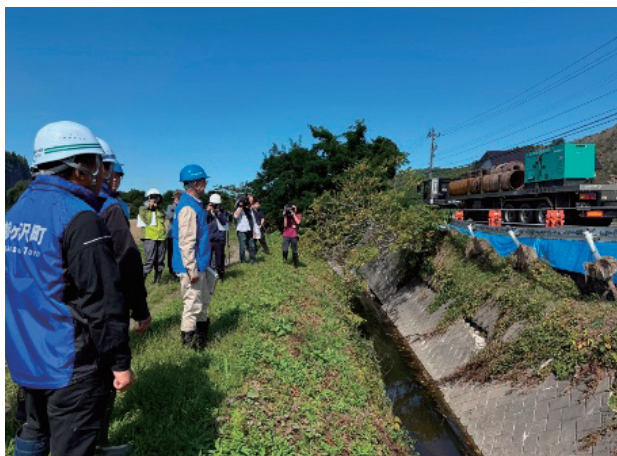
⑥被災状況
