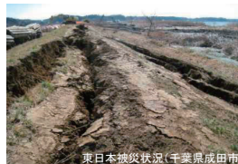
東日本被災状況(千葉県成田市)
